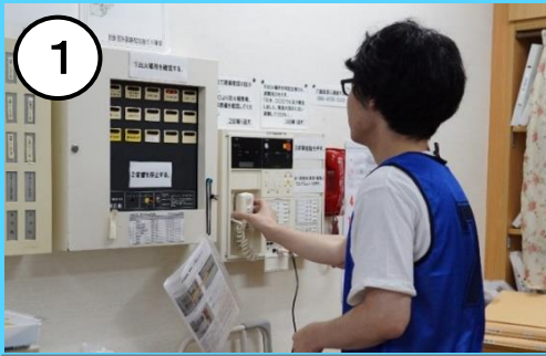
自動火災報知設備、発報。
